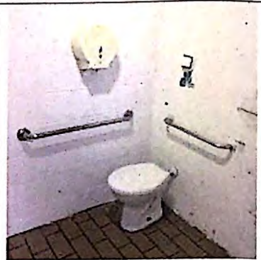
Vaso do box acessível com altura inferior a 43cm
