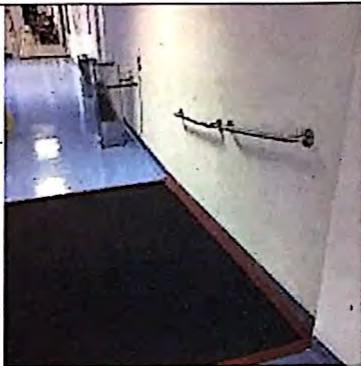
Rampa com inclinação maior que 8,33% e sem corrimãos
