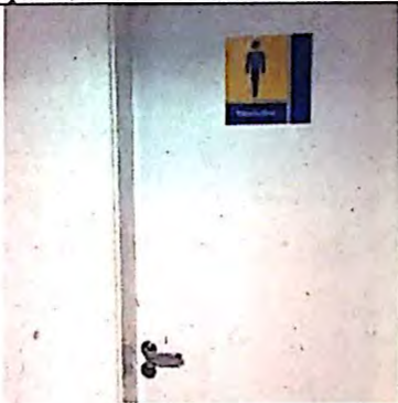
Sinalização visual de sanitário e não há sinalização tátil
