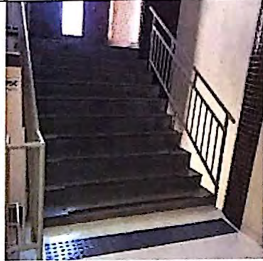
Escada sem corrimãos e degraus com alturas diferentes
