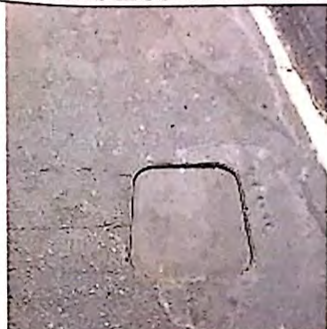
Tampa de PV com desnível no passeio lateral
