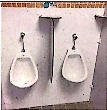
Mictório sem barra de apoio
