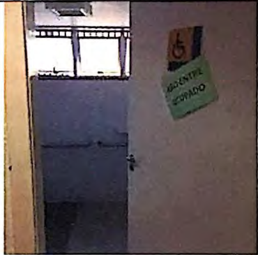
Porta de banheiro acessível não abre para fora
