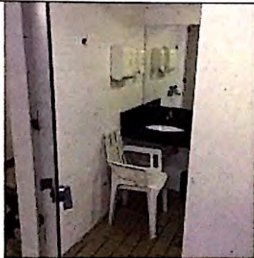
Porta de box acessível sem puxador vertical e sem barra horizontal interna
