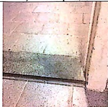
Desnível de soleira maior que 5mm
