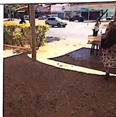
Piso irregular do acesso principal
